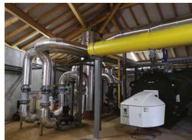
Chaudière à gaz au Centre sportif Richard Bozon
